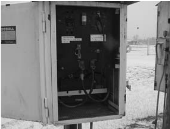
19.9 Air cooled rectifier.
